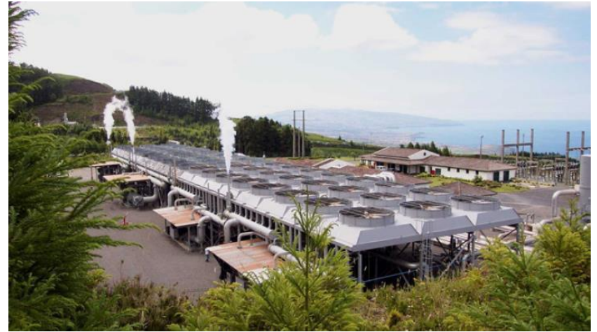
Central Geotérmica da Ribeira Grande 5 MW (1994) + 8 MW (1998)
